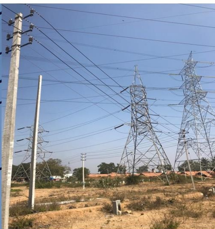
Below EHV Lines
